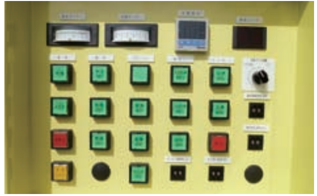
写真2 制御盤操作面
