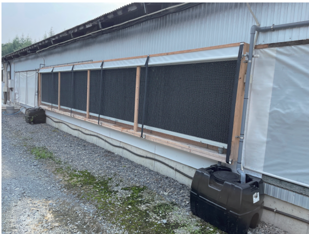
図13 (株)みずのクーリングパッド設置外観
